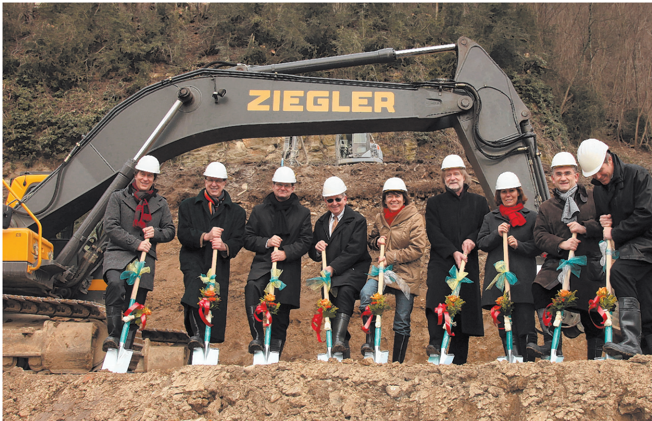
Stachen den Spaten (v.l.n.r.): A. Meyer, Geschäftsführer Brunnmatt; T. Studer, Präsident Baukommission; A. Guggenbühl, Stiftungsrat; R. Steinle, Stiftungsratspräsident; L. Studer, Stiftungsrätin; M. Avigni, Alterskommission; M. Sonderegger, Pflegedienstleitung; D. Buzzi, Bauleiter; R. Rosenmund, Architekt.
